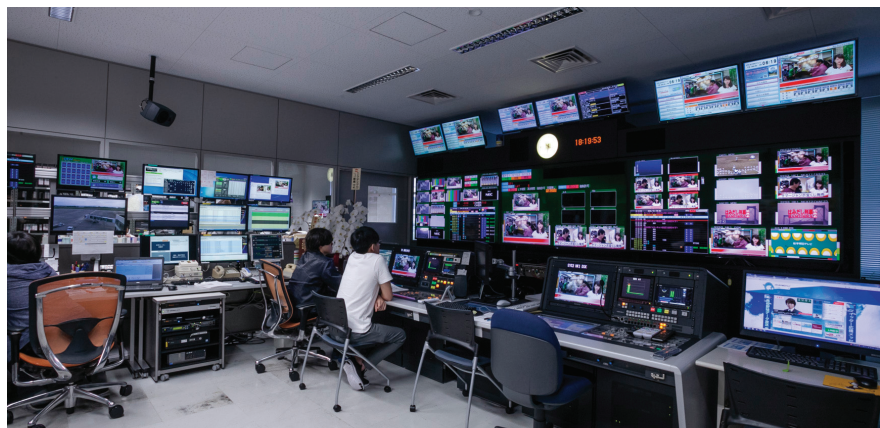
岩手朝日テレビのマスター・コントロール・ルーム。モニターには新規導入したデータ放送送出システムから送出されたデータ放送も表示されている
