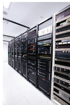
更新後の新しいマスター装置 (NEC製)
