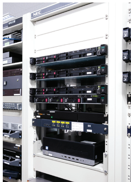
メディアキャストのデータ放送送出システム「DataCaster Cloud M3」の送出装置など。運用機能はAWSのクラウド上にある
